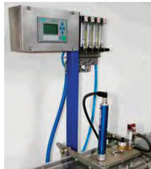
Siemens-SPS mit Vakuumregelung VR-3 .
